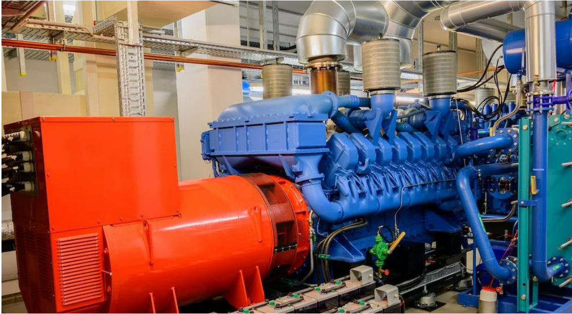
Figura 7. Fotografía de una central Diesel de 10 kW. Fuente: Tecnatom
